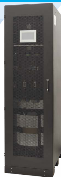
Силовой кабинет АБП
