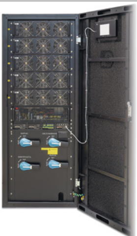
Кабинеты 150-1000 кВА на 50 кВт модулях
